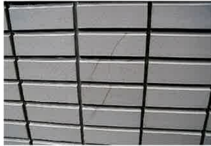
▲タイルの割れ
