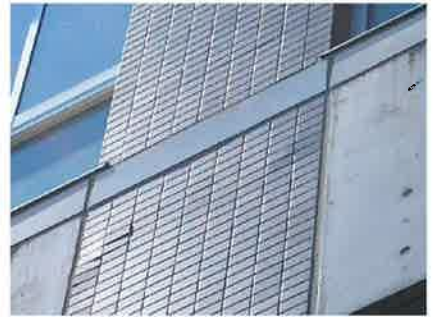
▲タイルの浮き、はく離
